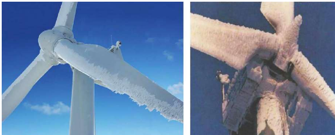
Rys. 1.25. Oblodzenie łopat turbiny wiatrowej (prawe zdjęcie przedstawia turbinę w stanie postoju) 156
